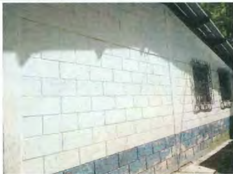
Foto 1: Las fachadas principales y laterales presentan desgaste notable de la pintura, con zonas donde el color original se ha desvanecido debido a la exposición prolongada al sol, la humedad y las lluvias.
