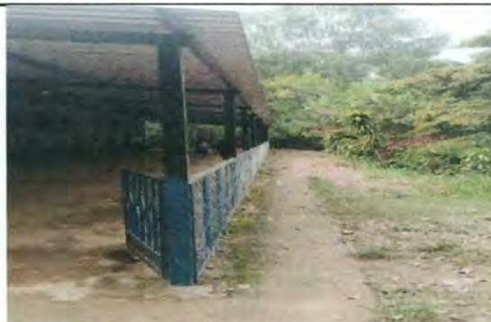
Foto 6: Por la falta de instalación de tubería de PVC para el adecuado drenaje pluvial, se ha provocado un deslizamiento de tierra frente a la escuela.
