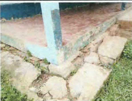
Foto 5: Se ha detectado que la banqueta está afectada por deterioro estructural, lo cual representa un riesgo para la seguridad de los alumnos que transitan por la zona.
