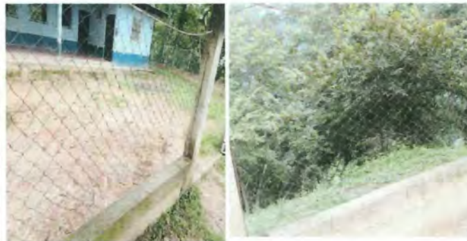
Foto 2: El muro perimetral del establecimiento educativo presenta deterioro visible en varios sectores, incluyendo fisuras, desprendimiento de material y zonas con corrosión en la base. Estas condiciones reducen su capacidad de cumplir adecuadamente con la función de protección y delimitación del recinto escolar.
