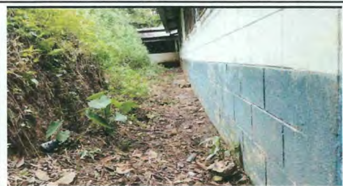
Foto 4: Debido a la falta de canales para la evacuación del agua de lluvia en las láminas del techo, el agua escurre directamente hacia la parte posterior de la escuela. Esto provoca acumulación de humedad, filtraciones y deterioro en las paredes y el terreno de esa zona, afectando el estado general de la infraestructura y generando condiciones inadecuadas para el uso del área.
