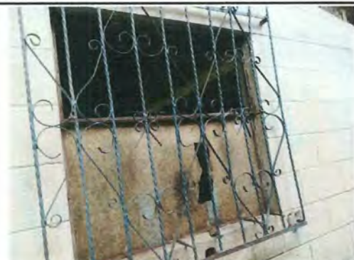
Foto 3: El establecimiento educativo presenta actualmente ventanas en mal estado, con marcos deteriorados, vidrios opacos o rotos y sistemas de cierre deficientes. Esta situación afecta tanto la iluminación natural como la seguridad de las aulas y demás espacios institucionales.
